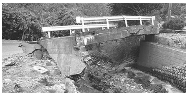
写真2 図1 地点② 損壊した橋
